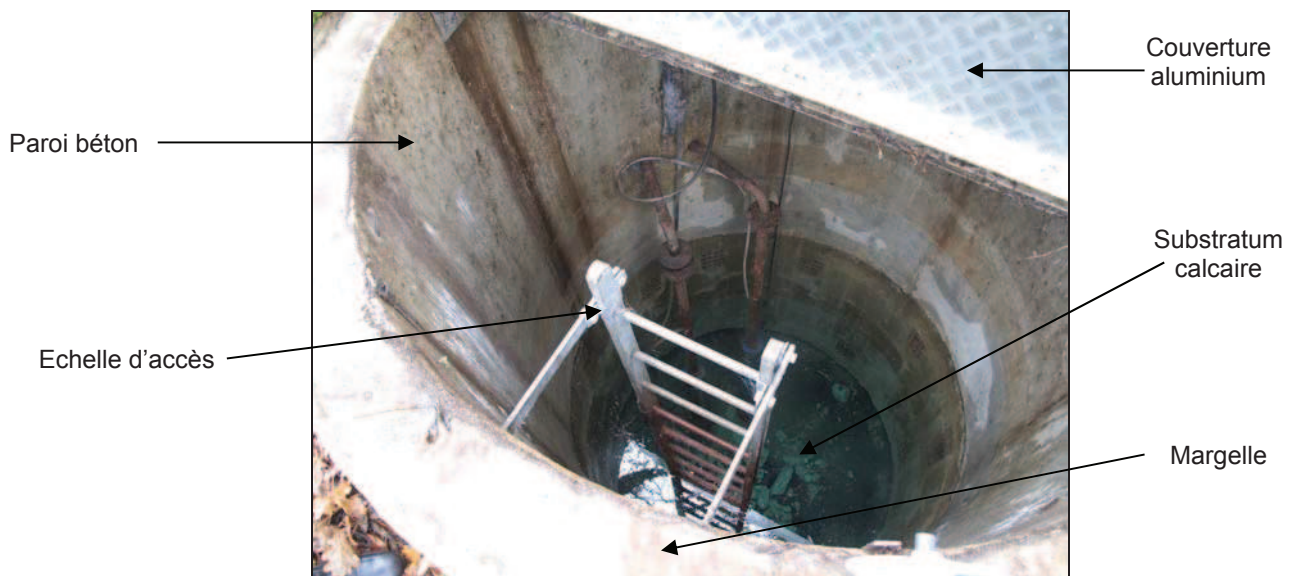
Figure 4 : Puits de captage
